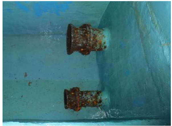
손상내용 2지 유출밸브, 배관, 볼트류 부식 손상원인 습기노출
