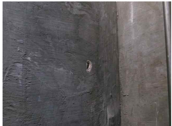
손상내용 유출밸브실 2지 벽체 철근노출 손상원인 피복두께 부족 및 다짐부족
