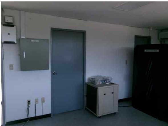
손상내용 전력 배전반 및 전기설비 상태양호 손상원인 -
