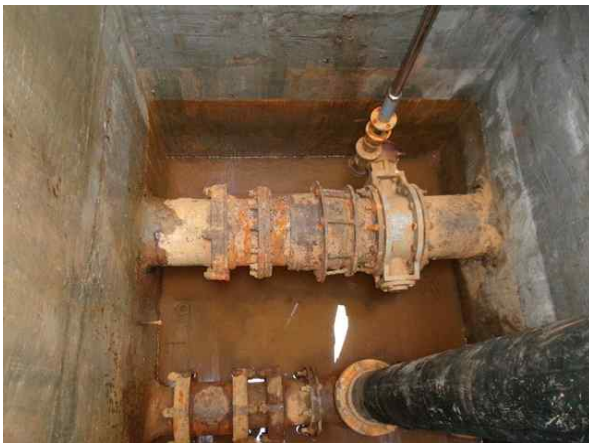
손상내용 유출밸브실 1지 배관, 볼트류 부식 손상원인 온도차에 따른 습기흡착 등
