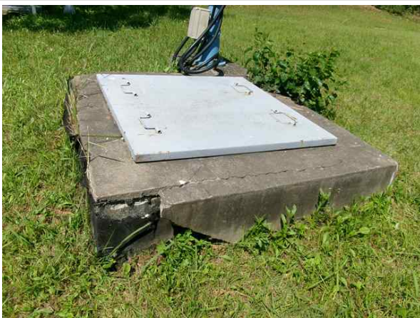
손상내용 유출밸브실 1지 입구 파손 손상원인 외부충격 및 다짐미흡
