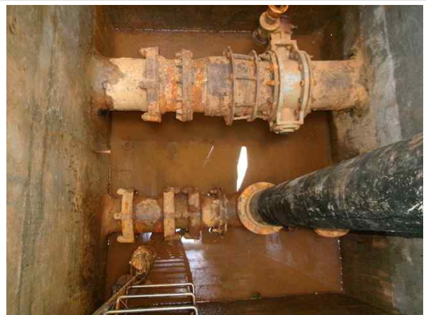
손상내용 유입밸브실 1지 하부슬래브 체수 손상원인 외부 우수유입
