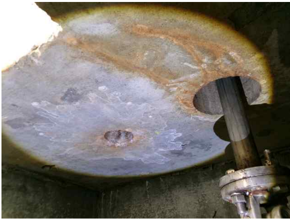
손상내용 유입밸브실 1지 상부슬래브 백테 손상원인 온도차이로 인한 습기흡착
