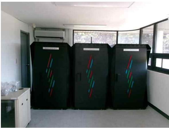
손상내용 전기실 전기설비 상태양호 손상원인 -
