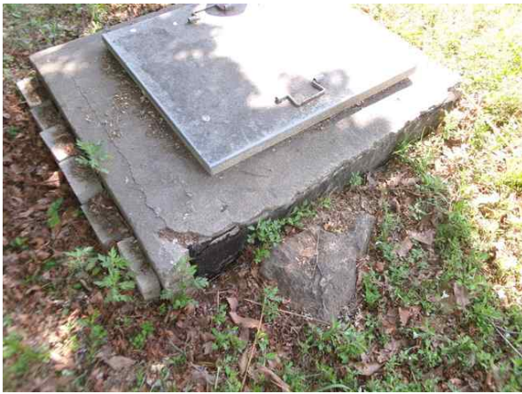
손상내용 유입밸브실 2지 입구 파손 손상원인 외부충격 및 다짐미흡
