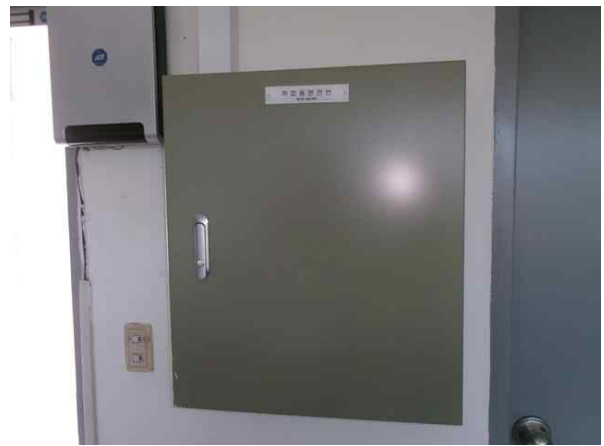
손상내용 전기실 작업용분전반 상태양호 손상원인 -
