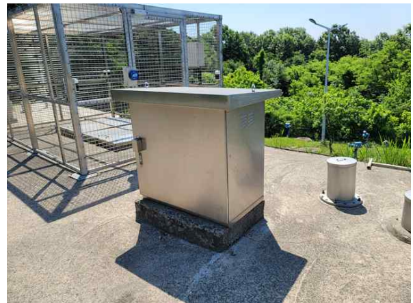
손상내용 외부 현장제어반 상태양호 손상원인 -
