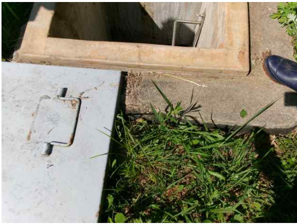
손상내용 유입밸브실 1지 입구 파손 손상원인 외부충격 및 다짐미흡
