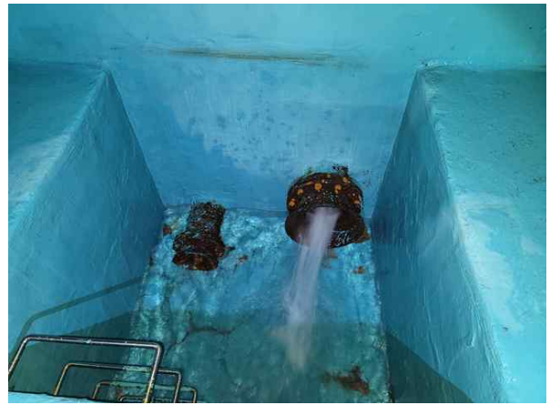
손상내용 1지 유출밸브, 배관, 볼트류 부식 손상원인 습기노출
