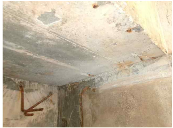
손상내용 유입밸브실 2지 상부슬래브 철근노출 손상원인 피복두께 부족
