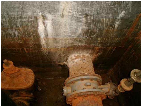
손상내용 유출밸브실 2지 벽체 백태 손상원인 온도차이로 인한 습기흡착
