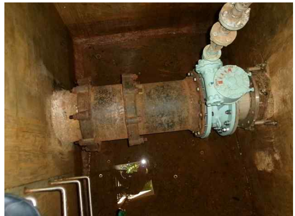
손상내용 유입밸브실 2지 배관, 볼트류 부식 손상원인 온도차에 따른 습기흡착 등
